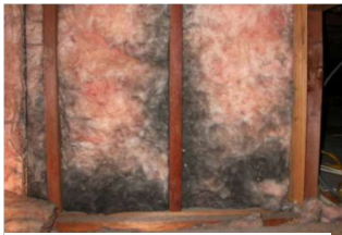
Isolant dégradé par l'humidité
