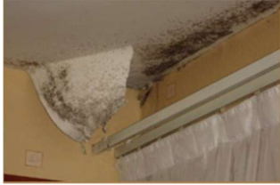
Moisissures au plafond
